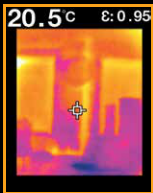
Wykrywanie gorącej rury w ścianie
